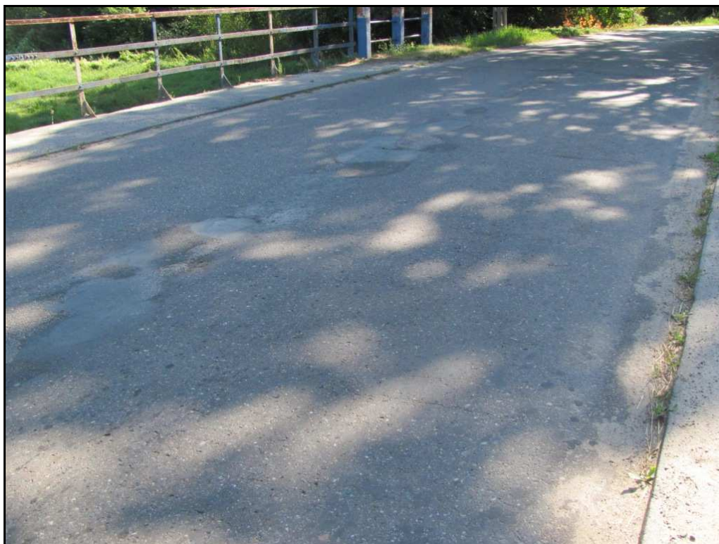
Zdj.5 Nawierzchnia jezdni na obiekcie - widczne spękania, deformacje i ubytki nawierzchni bitumicznej, ponadto wegetacja roślin i zanieczyszczenia w obrębie stref krawężnikowych.
