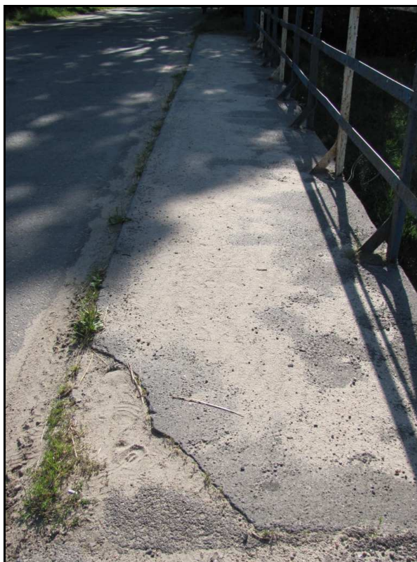
Zdj.9 Chodnik od strony górnej wody - widoczne zanieczyszczenia, ubytki nawierzchni bitumicznej.
