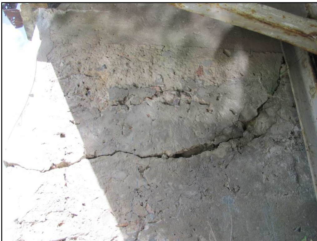
Zdj.23 Przyczółek lewobrzeżny - ścianka zapleczna - widoczne pęknięcia z ubytkami betonu.
