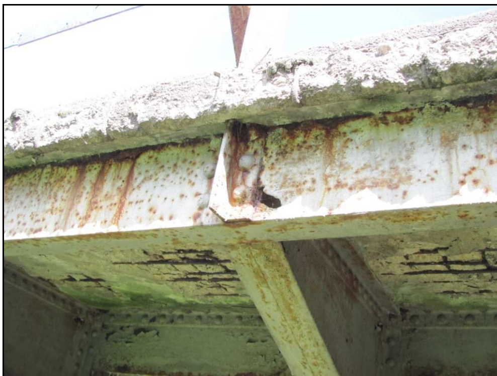
Zdj.32 Gzyms - widoczne wykruszenia i ubytki betonu oraz korozja odsłoniętego zbrojenia.
