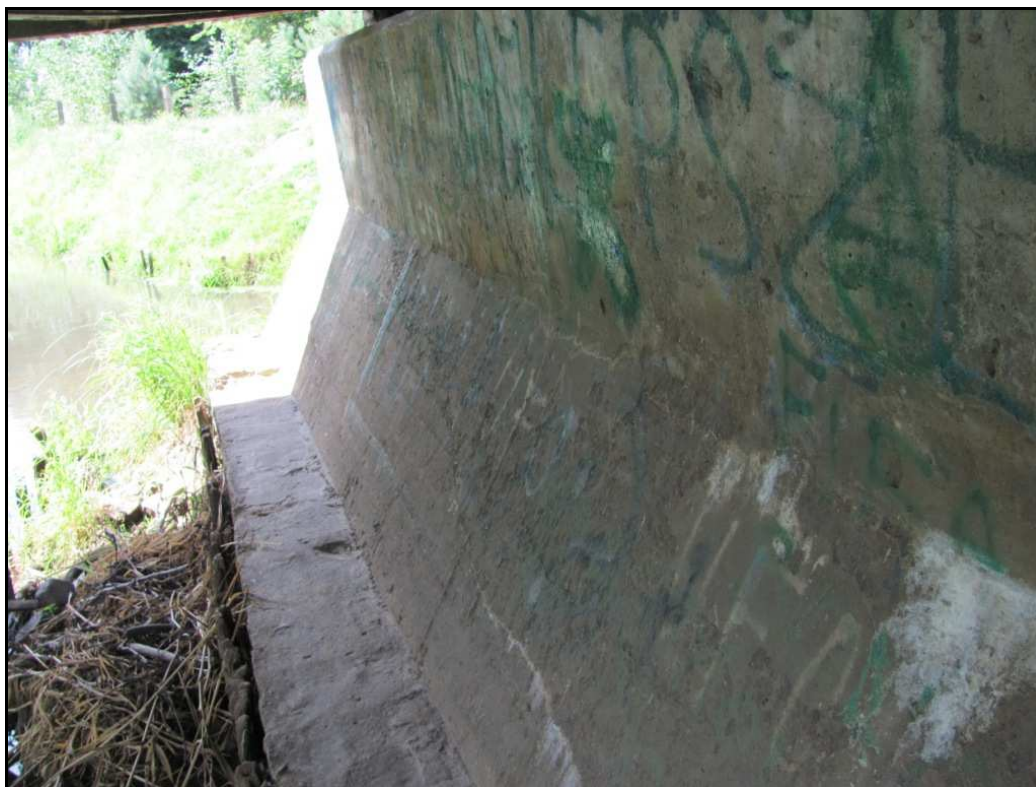
Zdj.22 Przyczółek lewobrzeżny - widoczne zanieczyszczenia w postaci graffiti, białe osady oraz ubytki betonu opaski przyczółka.
