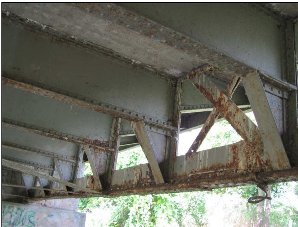
Zdj.26 Stalowa nitowana konstrukcja stalowa - widoczne złuszczenie powłok malarskich i korozja elementów stalowych.
