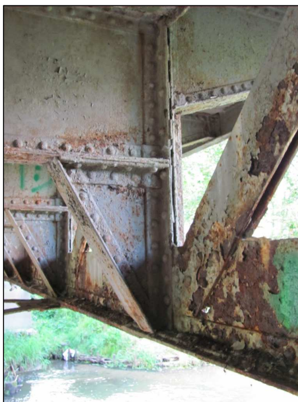
Zdj.24 Stalowa nitowana konstrukcja stalowa - widoczne złuszczenie powłok malarskich i korozja elementów stalowych.
