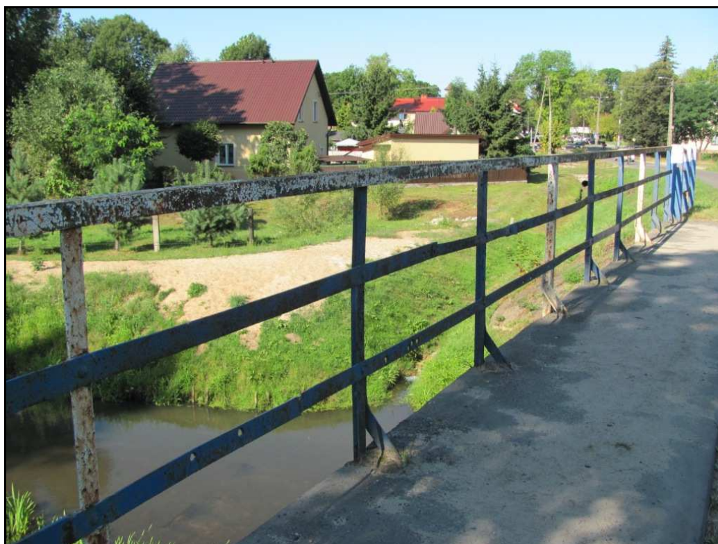
Zdj.10 Balustrada na moście - widoczne złuszczenie powłok malarskich, korozja powierzchniowa elementów stalowych.
