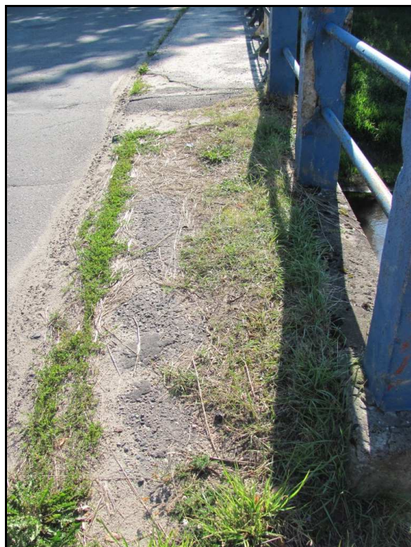
Zdj.8 Chodnik od strony górnej wody w obrębie skrzydła - widoczne ubytki i deformacje nawierzchni, wegetacja roślin, zanieczyszczenia.
