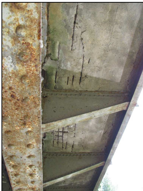
Zdj.30 Wspornik podchodnikowy - widoczne ubytki betonu, korozja odsłoniętego zbrojenia, zielone osady.
