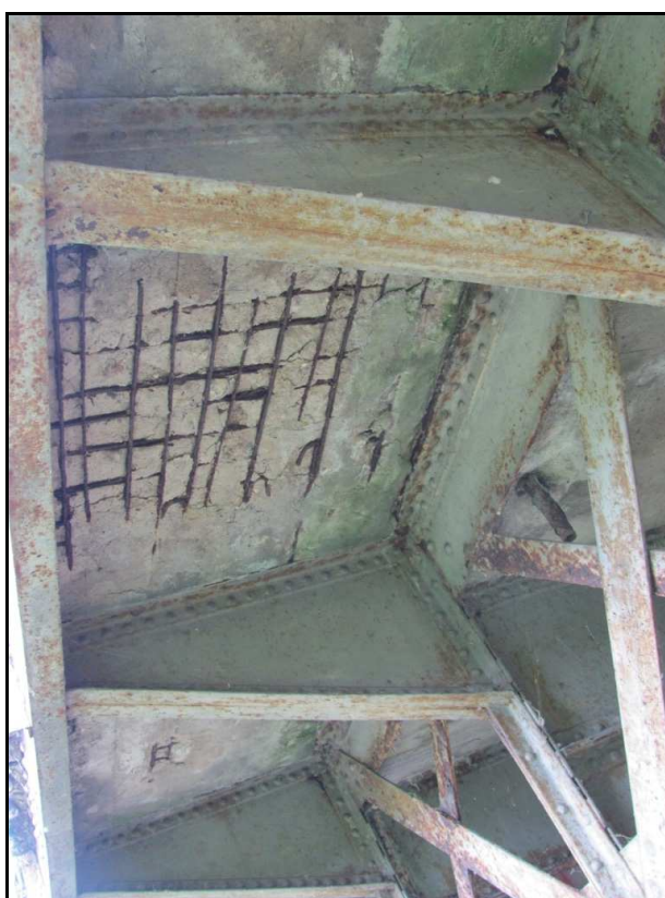
Zdj.28 Wspornik podchodnikowy - widoczna odsłonięte skorodowane zbrojenie, ubytki betonu, zielone osady i wykwity.
