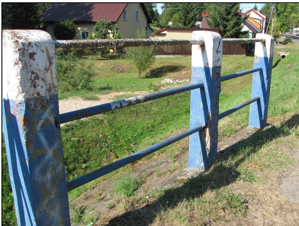
Zdj.11 Balustrada na skrzydle - widoczne ubytki betonu słupków, złuszczenie powłok malarskich na elementach stalowych i betonowych.
