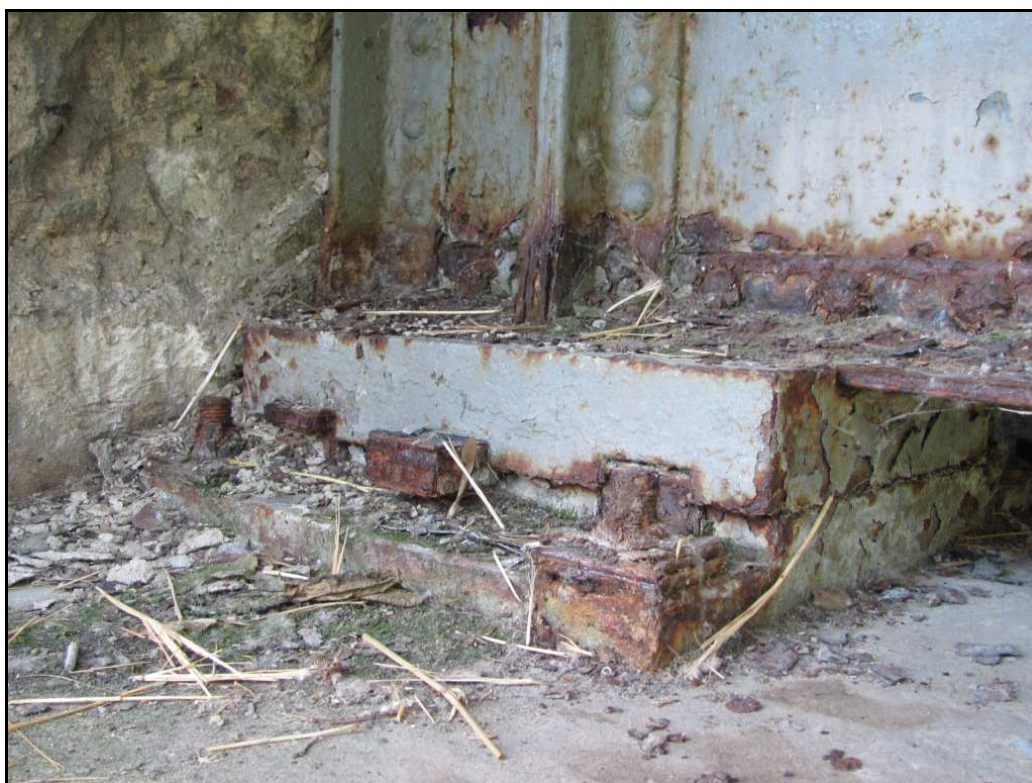
Zdj.20 Łożysko od strony dolnej wody (prawy brzeg) - widoczne zanieczyszczenia, złuszczenie powłok malarskich i korozja powierzchniowa elementów.
